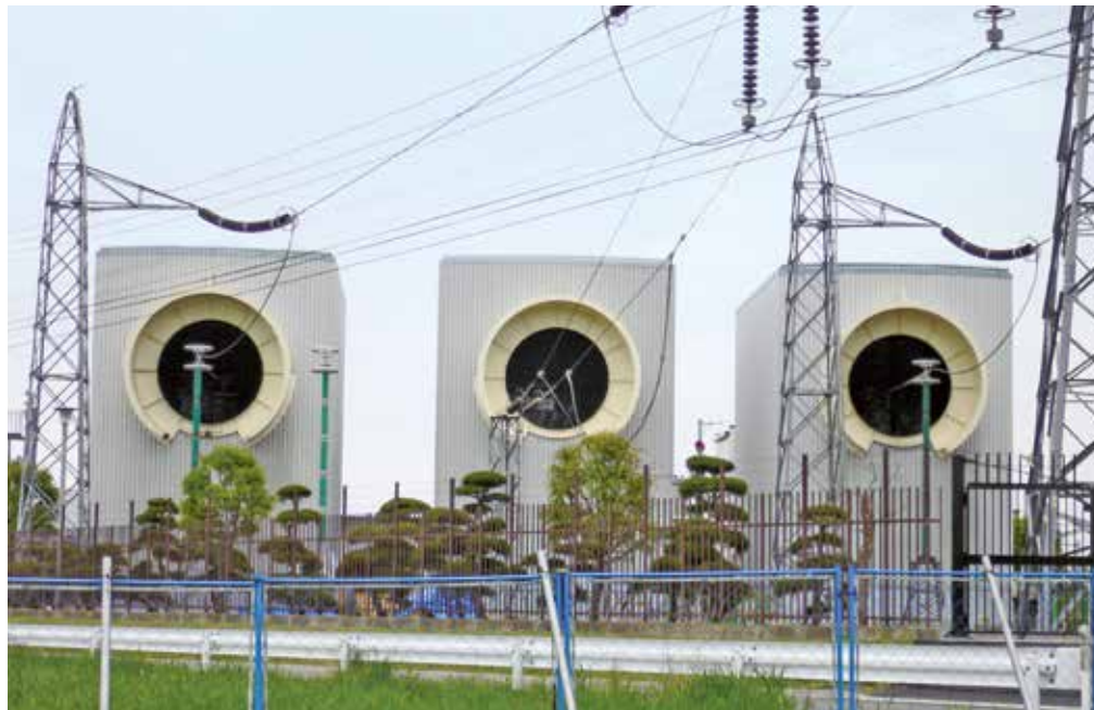
電源開発(株)北日本直流幹線 第3ケーブルヘッド建屋
